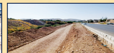
پروژه های عمرانی شورای منطقه ۱۰: پروژه محرومیت زدایی، پیاده راه، تهر اعظم واقع در شهرک حسین آباد که پیاده راه در ضلع شمال و جنوب با عرضی سه متر به طول یک کیلومتر تا ۱۵ متر در پیرفت فیزیکی
