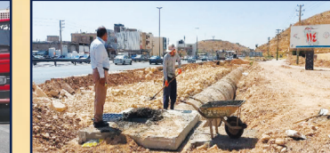
پروژه عمرانی شهرداری منطقه ۱۰: پروژه لوله گذاری دفع آبهای سطحی محور گویم سپیدان
