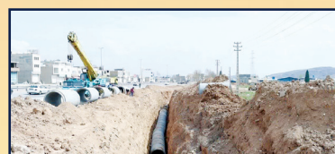
پروژه عمرانی شورای منطقه ۱۰: پروژه لوله گذاری دفع آبهای سطحی پیرفت فیزیکی: ۹۲ درصد - هدف: دفع آبهای سطحی شهرک های گویم زمینس و انتقال آن به رودخانه طبع شمالی باغات گویم
